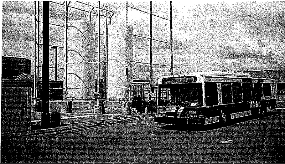
Vertical LNG Tanks at Tempe Transit
